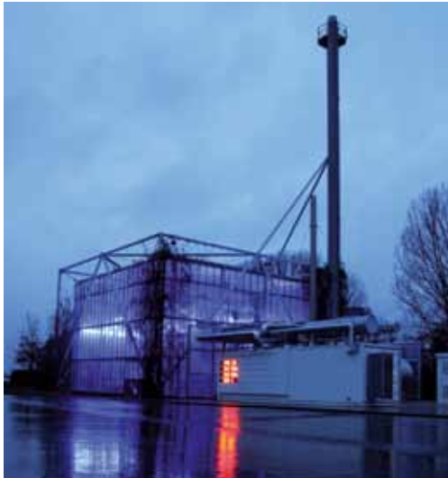
Energía renovable procedente de la central de calefacción por cogeneración
